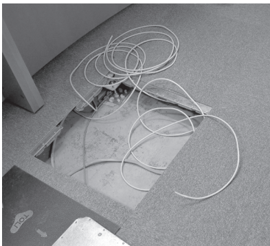
写真8 床下を這う配線
