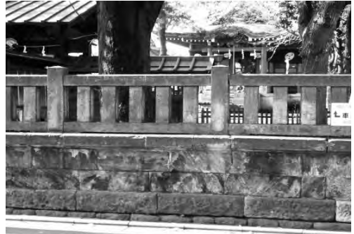
写真4 ブロック塀の隙間
